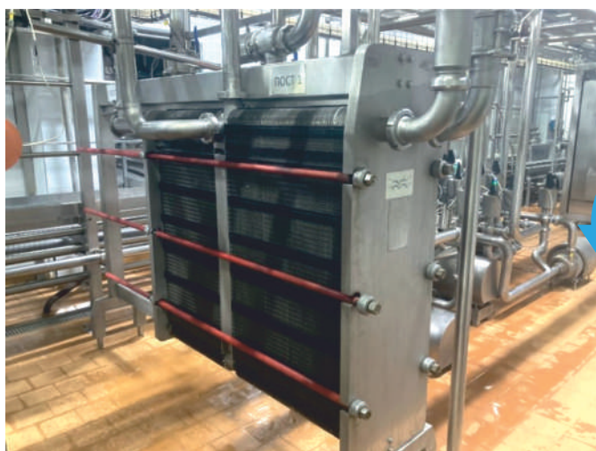
Теплообменник Alfa Laval заказчика
